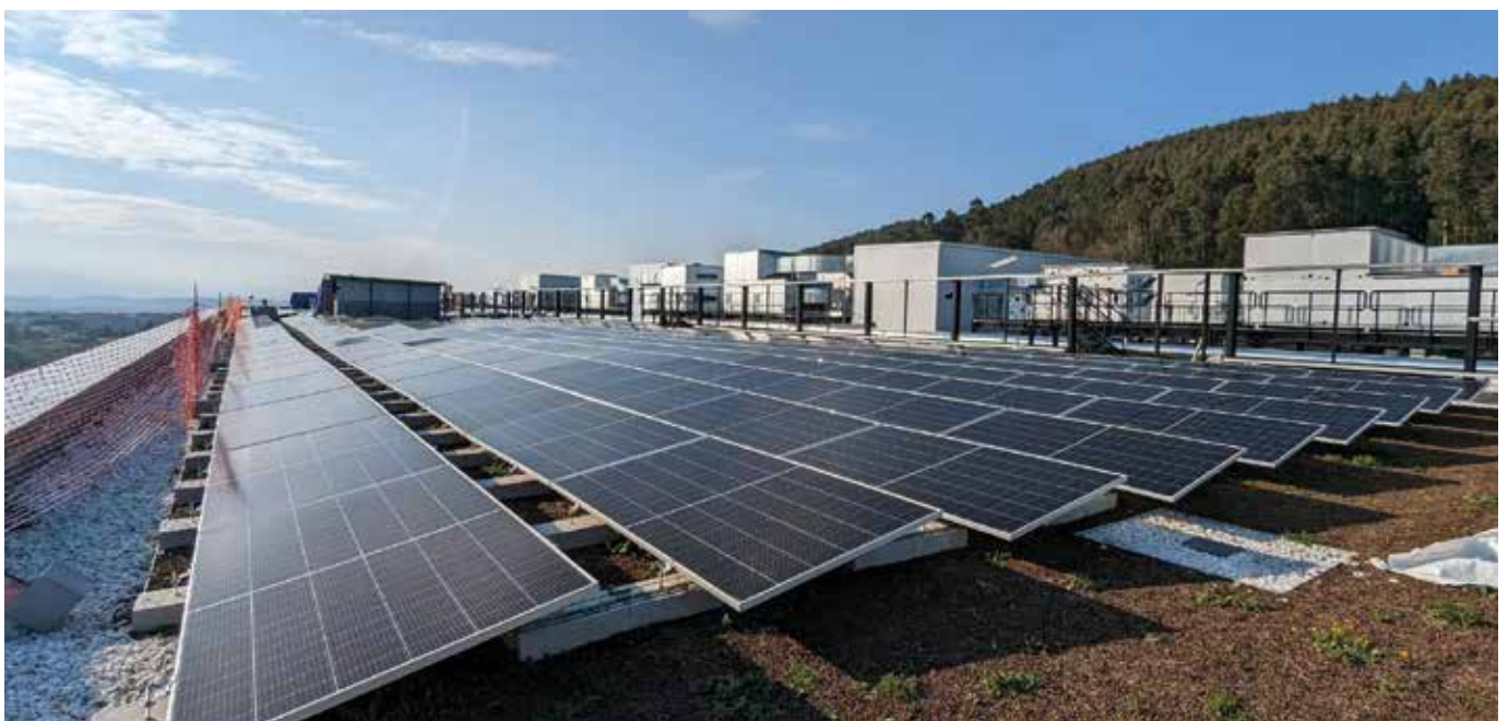
Foto: Instalación fotovoltaica de la futura planta de producción farmacéutica de Derio (Bizkaia).
