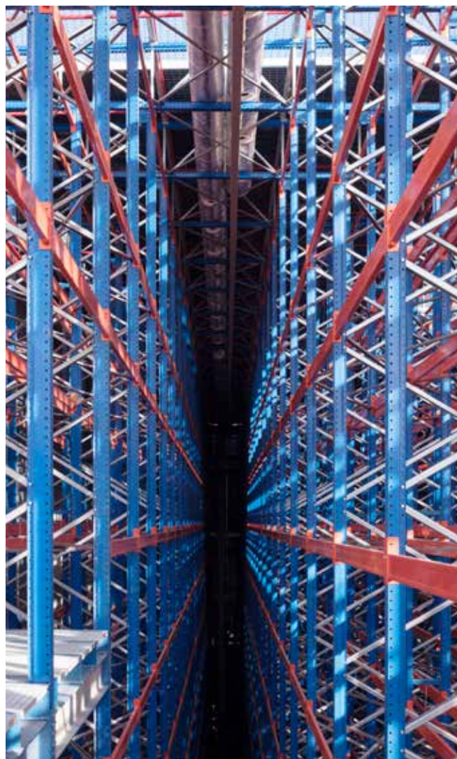
Foto: Próximo almacén de la nueva planta farmacéutica de Derio (Bizkaia).
